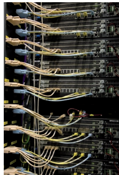
Vermittlungsanlage zwischen VoIP und Festnetz: Swisscom investiert laufend in zukunftsfähige Netzinfrastrukturen
